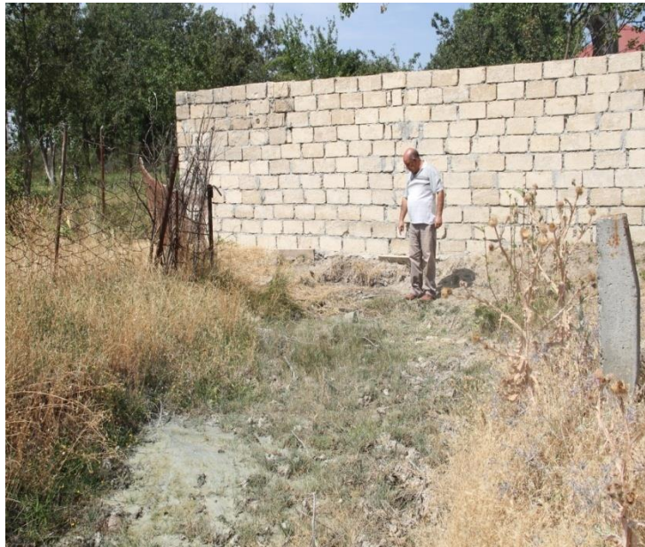
Şəkil 4.14 . Şamaxı rayonu Hacılar kəndi içərisində kiçik palçıq vulkanı (iyun 2017-ci il).
